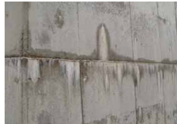
水槽 : セパ孔, 打継目から
