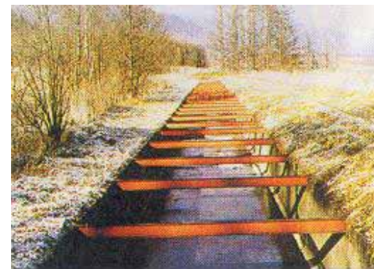
開水路側壁(凍上圧の補強対策)
