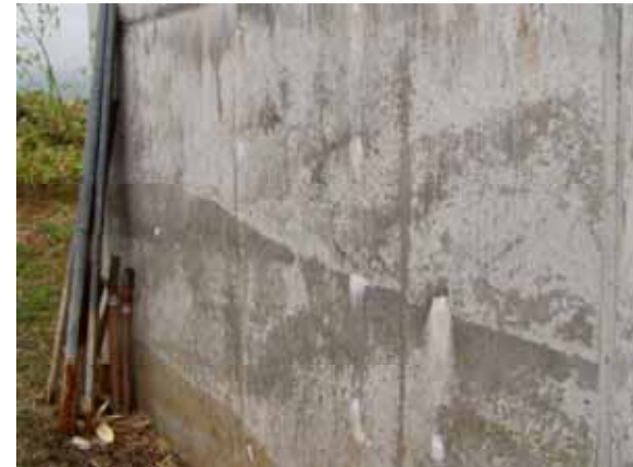
水槽 : コールドジョイントから
