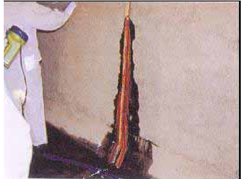
目地からの漏水
