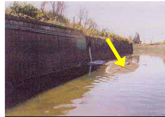
開水路底版(浮力による損傷)
