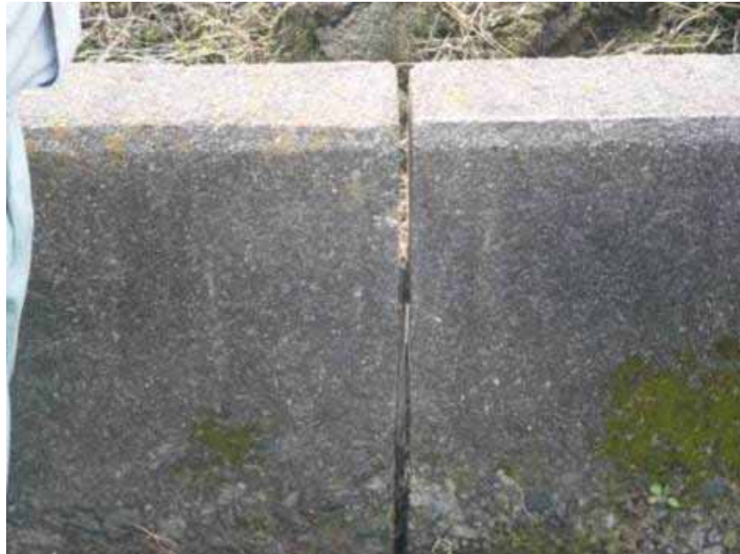
目地材の脱落
