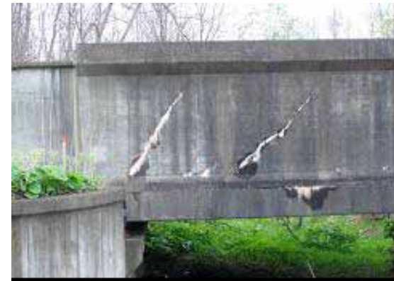
水路橋: せん断力不足
