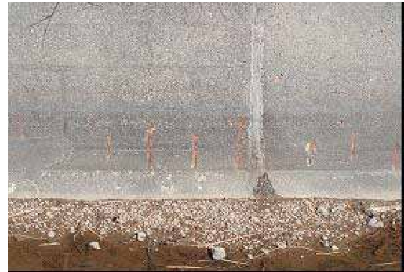
開水路側壁：鉄筋露出
